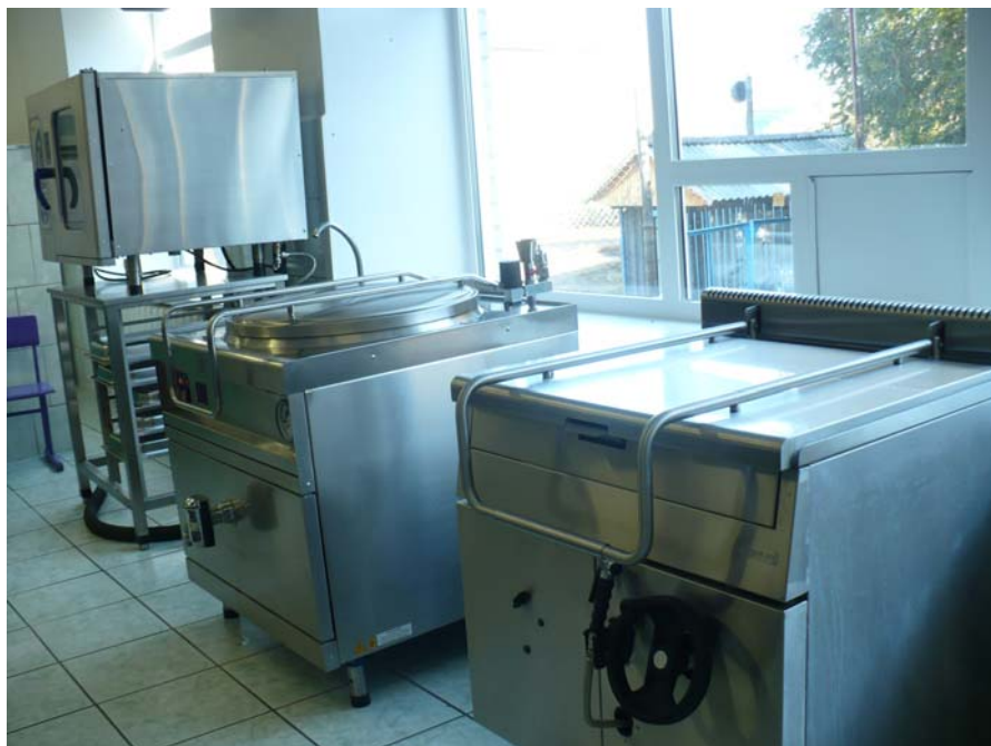
Пищеварочный котёл и электрическая сковорода
